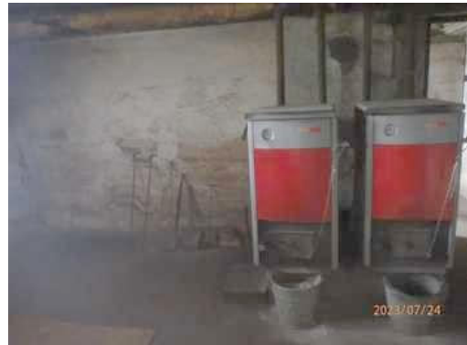
sklepy - kotelna pro dva byty
